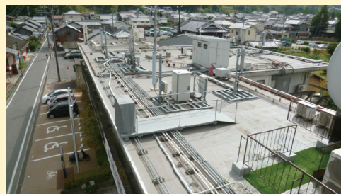
本庁舎屋上 通信設備機器や配管が前面を覆い、景観阻害要因になっている。
