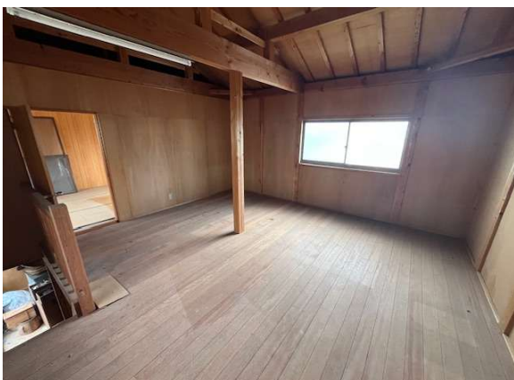
( 農業用倉庫 2階 )
